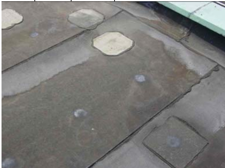
Figuur 1: Voorbeeld van een beschadigd dak
